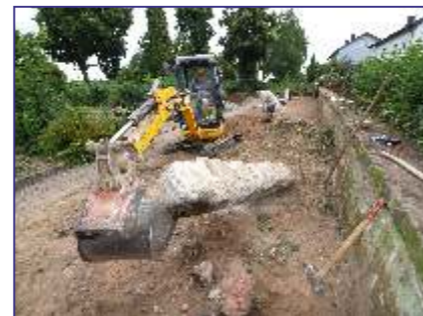
Bauhofmitarbeiter Remi Stuppy (auf dem Bagger) und Uli Wätzold (ehrenamtlich tätig) legen das neue Rasenfeld für künftige Urnenbestattungen an
