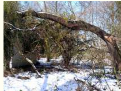
Der Schneebruch im April hat auch das alte Katzenbacher Wasserhaus stark in Mitleidenschaft gezogen
