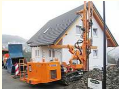
Eine neue Heizung braucht die „Villa Kunterbunt“. Auch Erdwärme wird geprüft.
